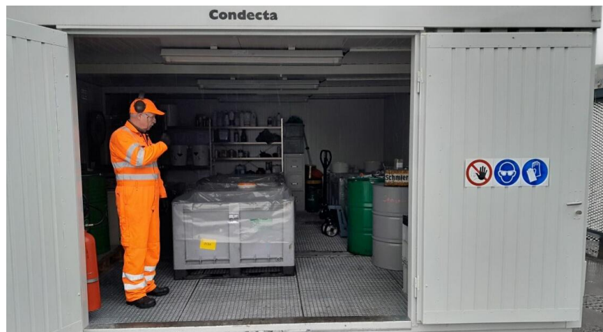
Bild 8: Aufbewahrung Batterien in separatem Raum, Ökihof, Zug
