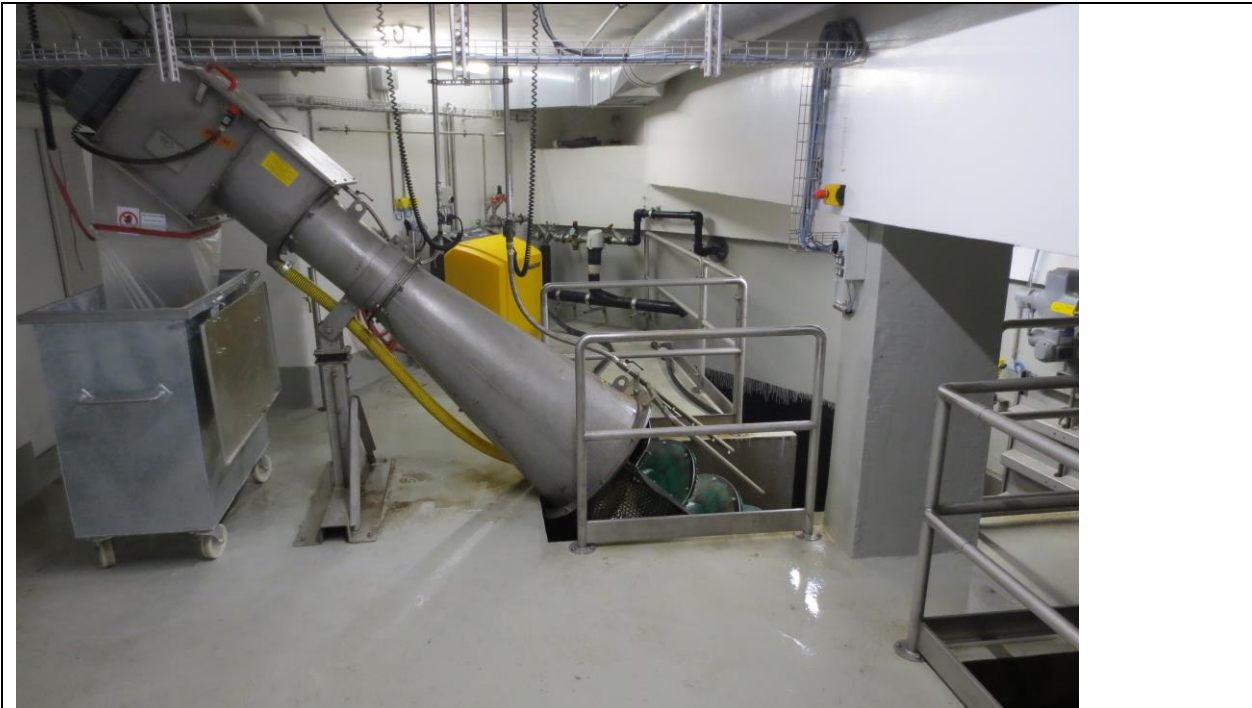
Abb.: Einlauf der Schmutzwasserleitung ins Pumpwerk mit Rechenanlage und Förderschnecke, damit Fremdkörper herausgefiltert und ausgeschieden werden können (Bauamt St. Moritz)
