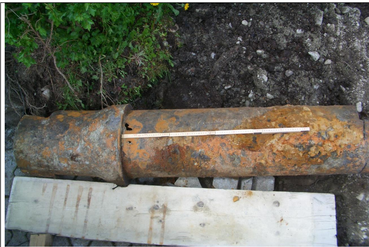
Abb.: Korrosionsschäden an Leitung verursacht durch saures Moorwasser (Bauamt St. Moritz)
