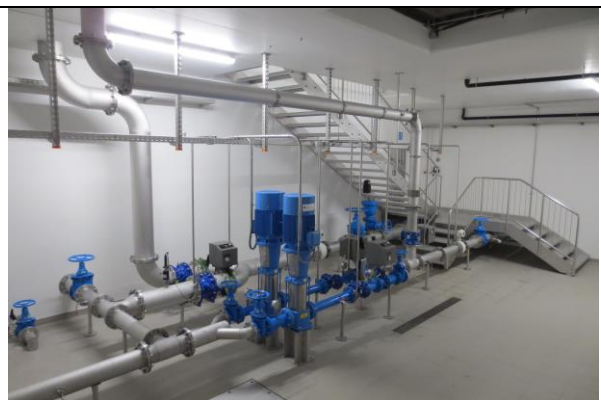
Abb.: Rohrkeller (Bauamt St. Moritz)
