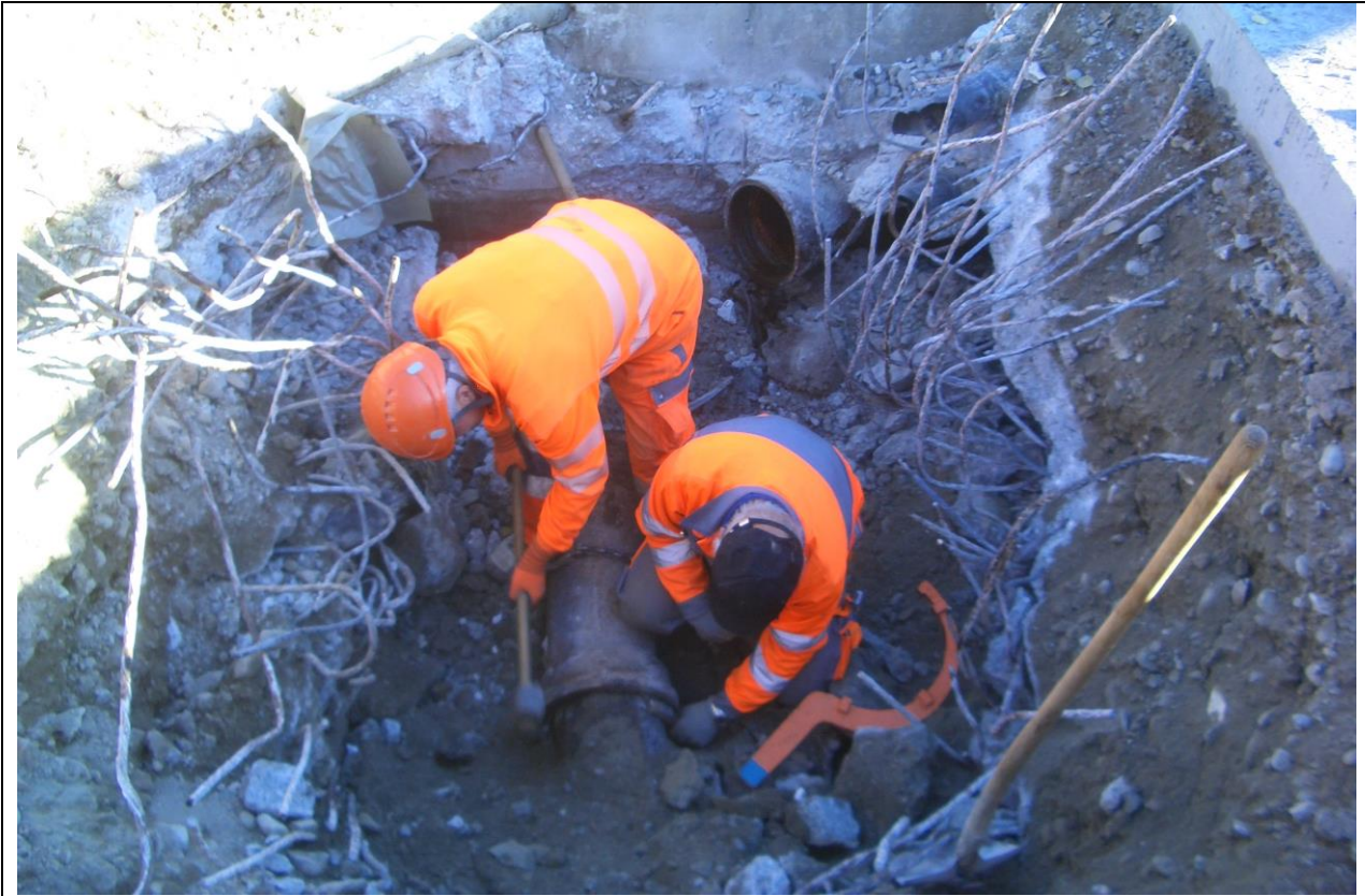
Abb.: Beginnende Reparaturarbeiten, nachdem endlich die Fahrbahn auf- und die Armierung der Schleppplatte durchbrochen war (Bauamt St. Moritz)
