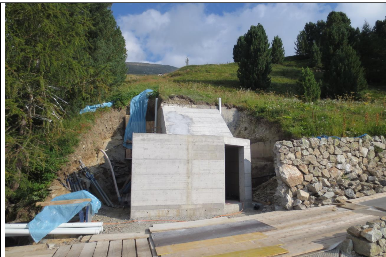
Abb.: Neu erstellter, ebenerdiger Eingangsbereich zum Reservoir Clavadatsch vor dessen Verkleidung mit einer Bruchsteinmauer (Bauamt St.Moritz)
