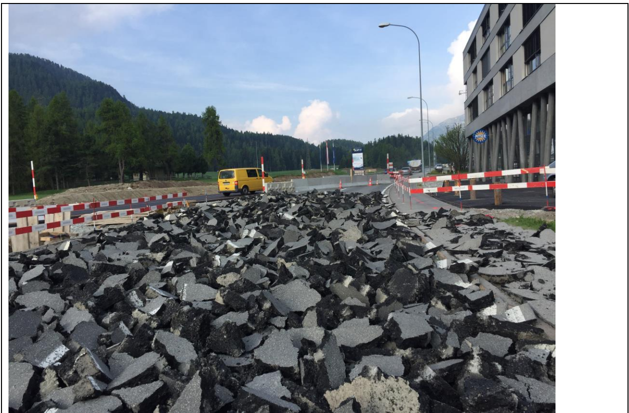
Abb.: Abbruch der bisherigen Strasse nachdem die Notumfahrung in Betrieb genommen werden konnte (Bauamt St. Moritz)
