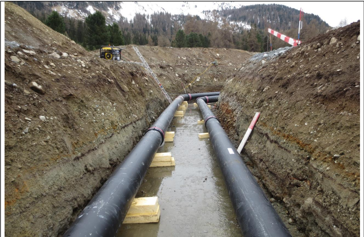
Abb.: Neu verlegte Transportleitungen von Grundwasserpumpwerk San Gian II zur Zentrale San Gian im Bereich des neuen Kreisels (Bauamt St.Moritz)
