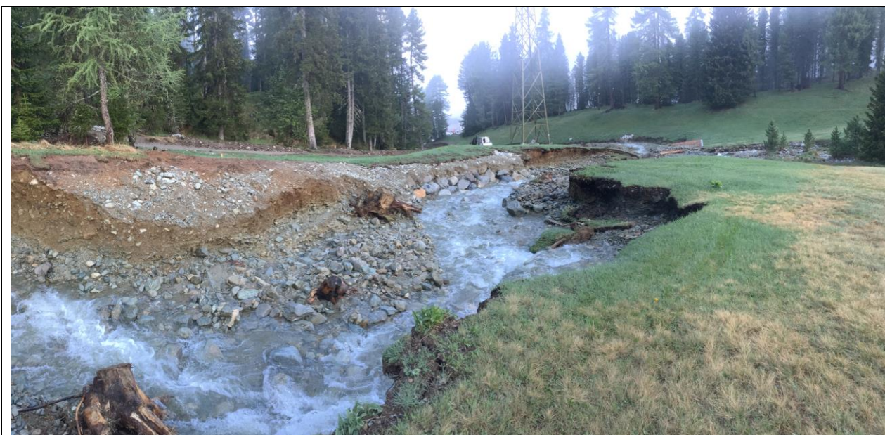
Abb.: Erosionsanrisse im Bereich des neu gestalten Gerinnes (Bauamt St. Moritz)
