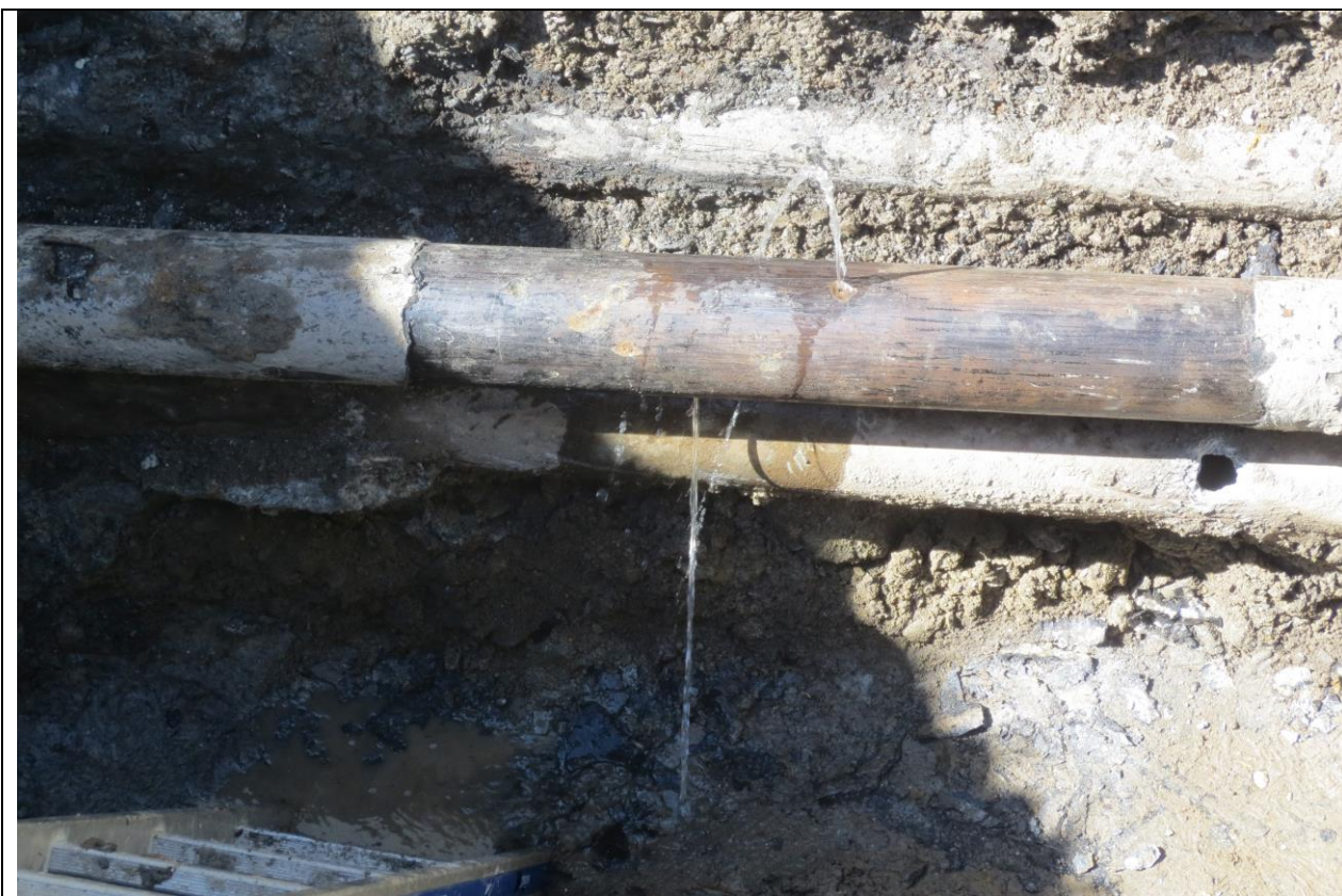
Abb.: Weitere Schäden an der defekten Leitung Brattas (Bauamt St.Moritz)
