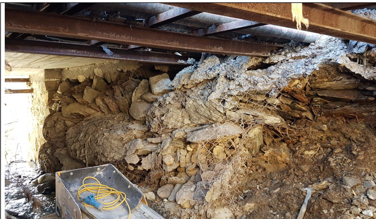
Abb.: Blick unter die Brücke CheCha mit den teilweise aufgeplatzten Steinkörben (Bauamt St. Moritz)
