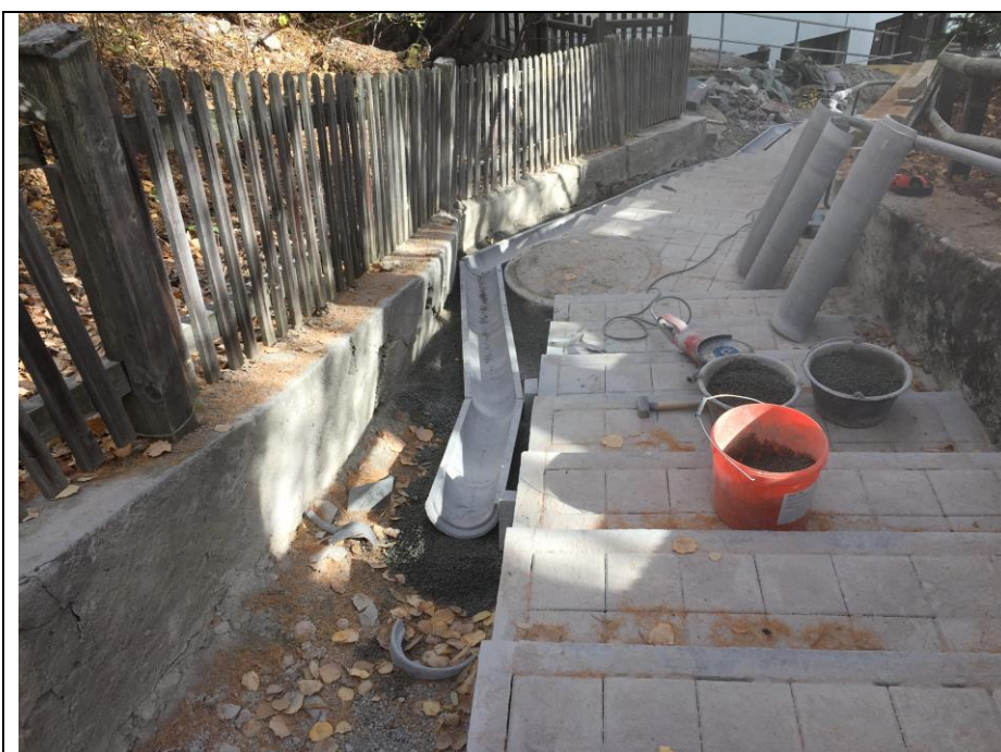
Abb.: Sanierung der Truoch Stredas mit der neu verlegten Längsentwässerung (Bauamt St. Moritz)
