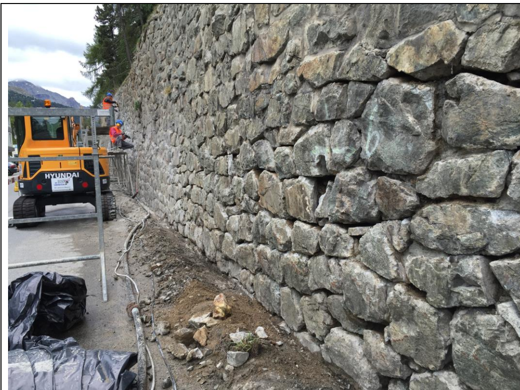
Abb.: Sanierungsarbeiten an den bergseitigen Stützmauern der Via Somplaz (Bauamt St. Moritz)
