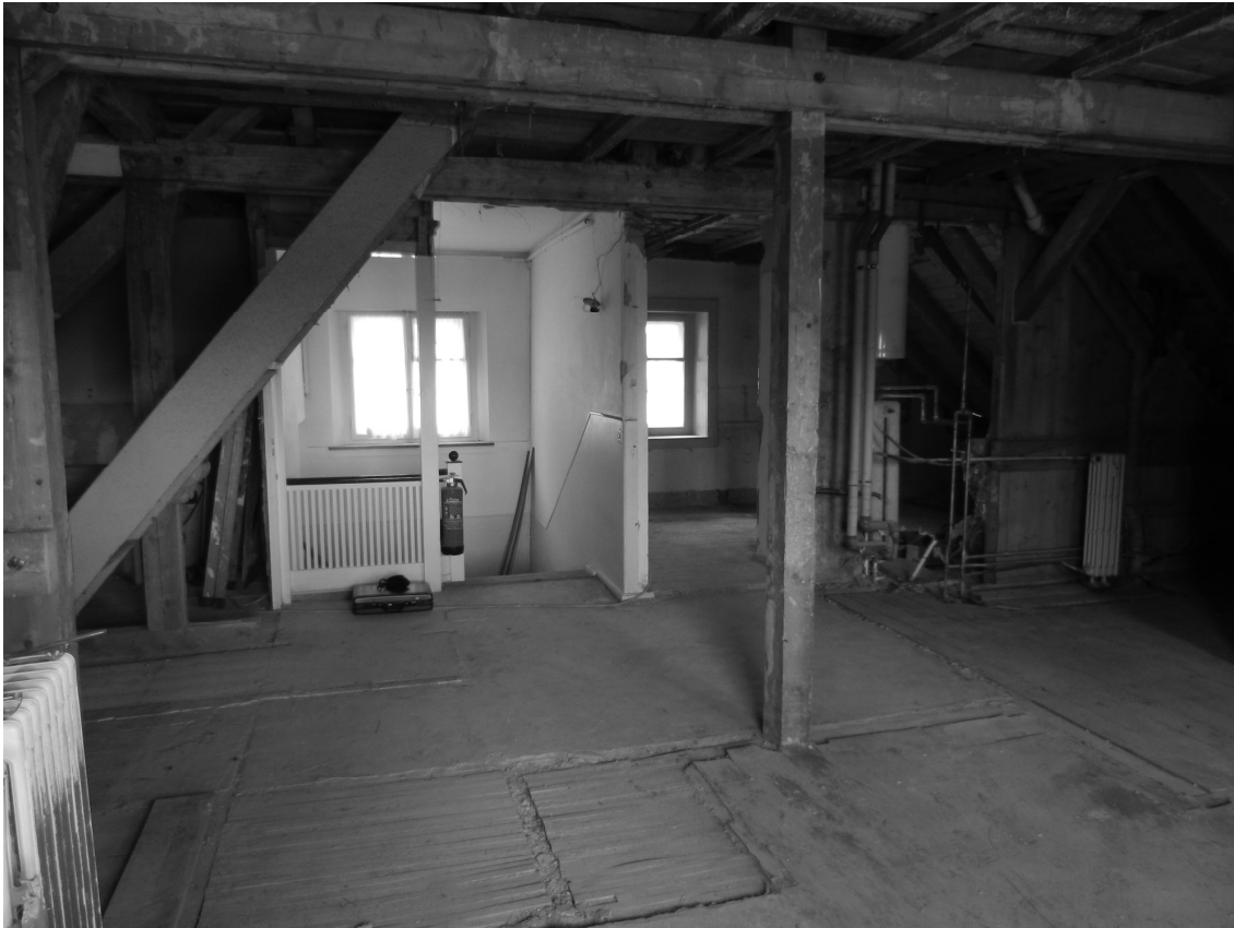
Abb: Umbaumassnahmen in einer Wohnung ohne Vorliegen einer Baubewilligung (Bauamt St. Moritz)
