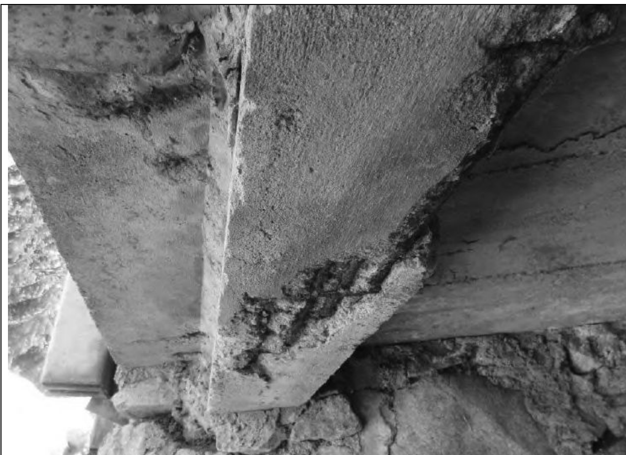
Abb.: Alarmierender Zustand durch grössere Betonabplatzungen an den Längsträgern und starke Korrosion an der Armierung (AF Toscano)
