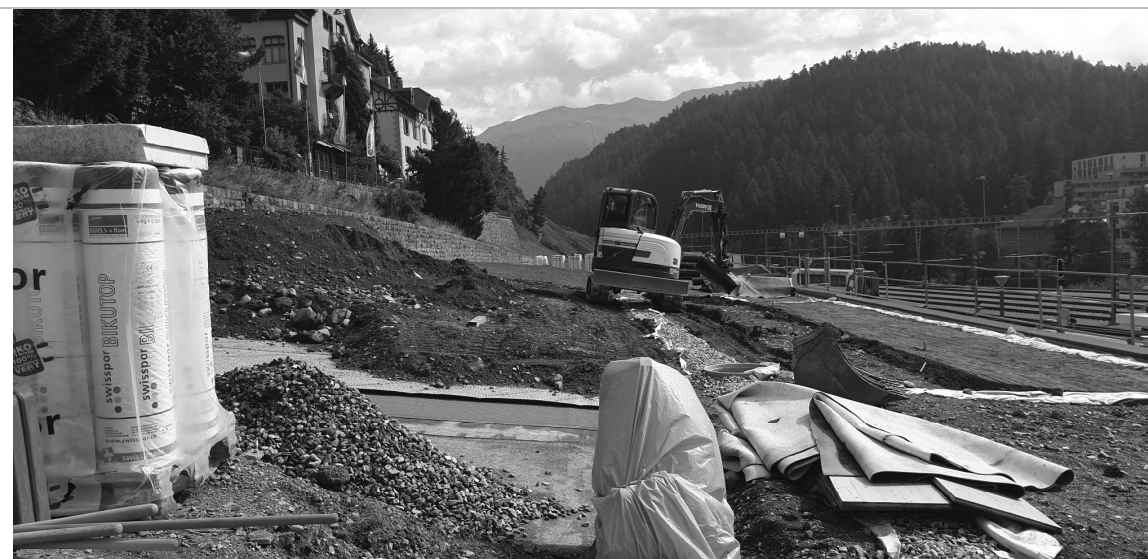
Abb.: Nach dem Abdichten des Daches wird dieses wieder eingedeckt und begrünt (C. Albasini)
