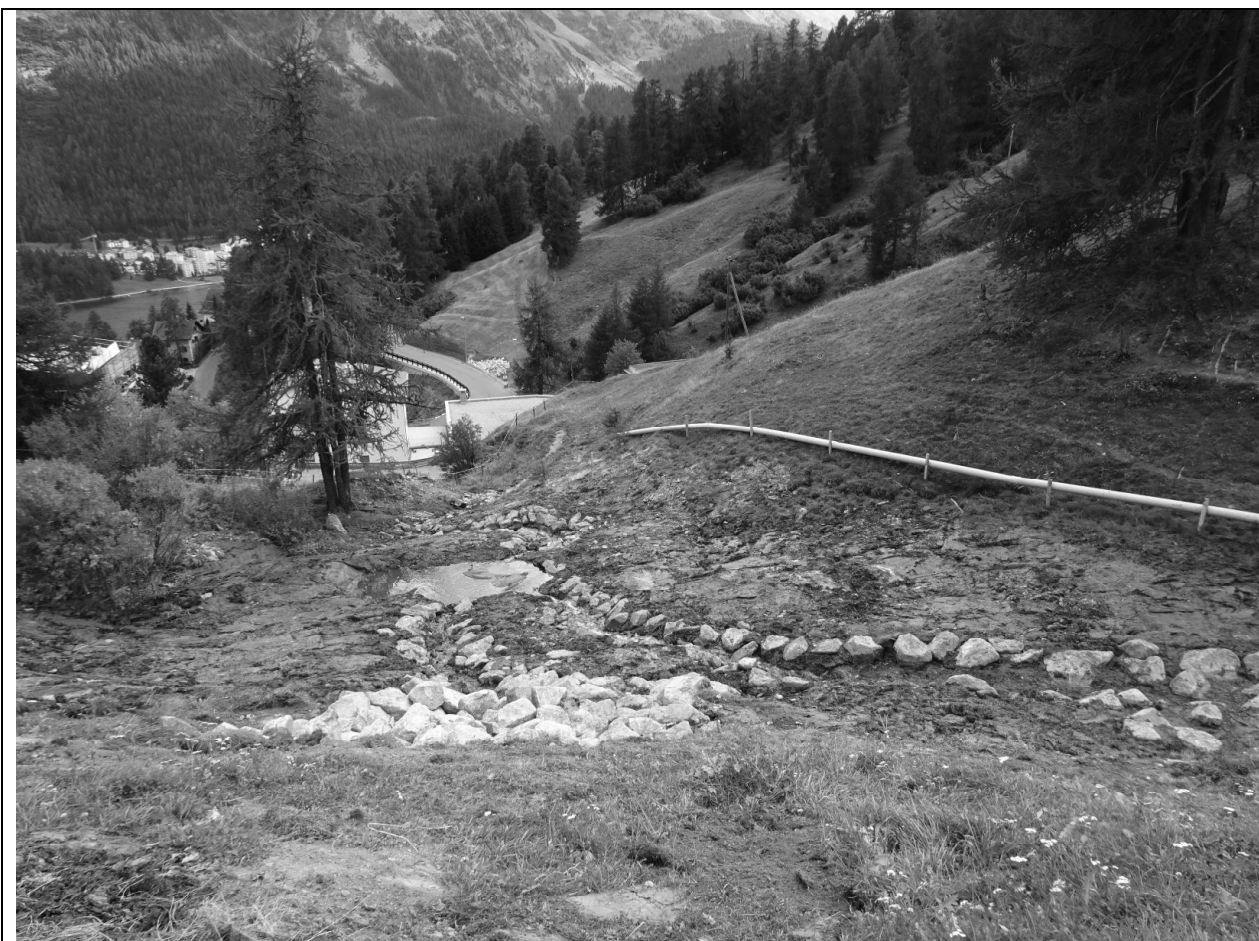
Abb.: Die als kleiner Eingriff geplante Lecksanierung entpuppte sich als veritabler Eingriff (Bauamt St. Moritz)
