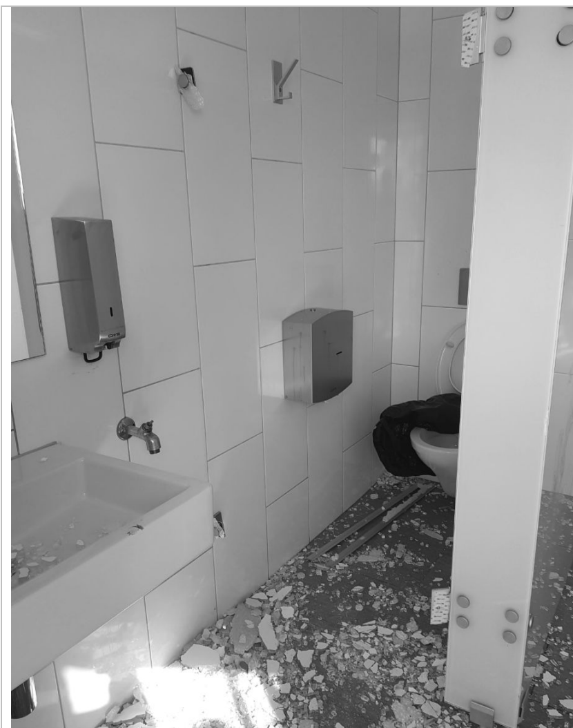
Abb.: Augenschein nach einem Besuch von Vandalen (Bauamt St. Moritz)
